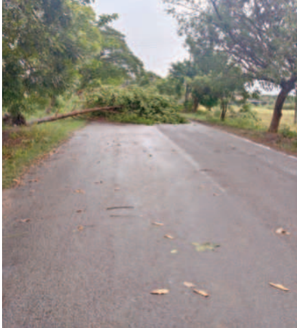
చిన్నకోడూరు-ఇల్లంతకుంట రోడ్డుపై విరిగిపడిన హరితహారం చెట్లు
